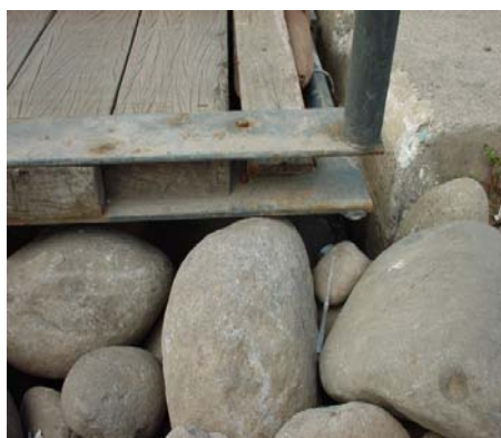
Figura N° 39. Acumulación de material de relleno por debajo de la rampa Norte.
