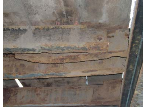
Figura N° 8. Vigas secundarias longitudinales. Seltas y desalineadas
