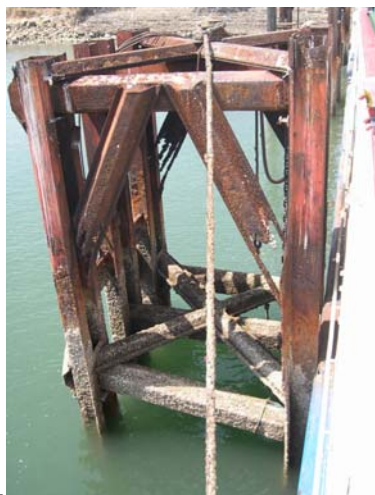
Figura N° 23. Duque de alba completamente deteriorado
