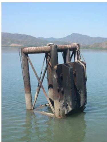
Figura N° 5. Duque de alba golpeado y seriamente deteriorado.
