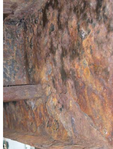
Figura Nº 26. Vigas principales severamente corroídas
