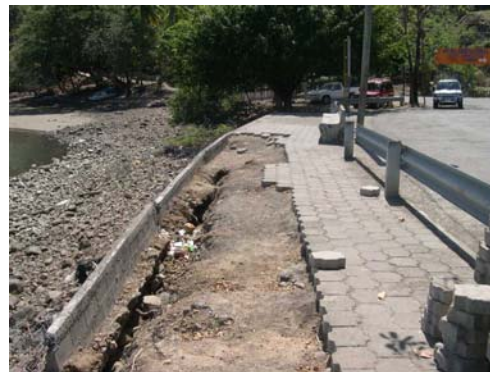
Figura N°14. Problemas de erosión cerca de la vía de acceso principal
