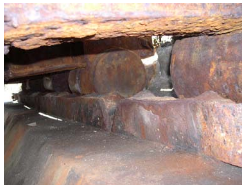
Figura N° 30. Apoyos deteriorados sin mantenimiento con lubricante
