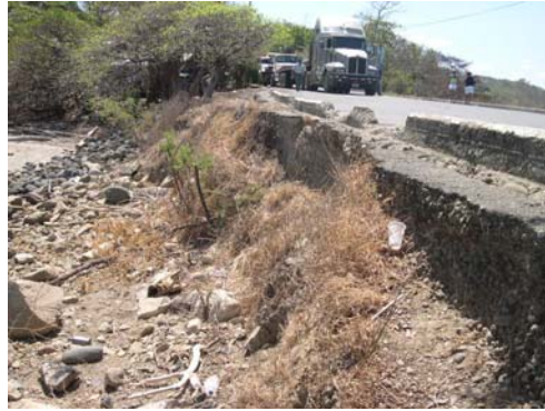
Figura Nº 31. Sector del acceso en peligro de colapsar
