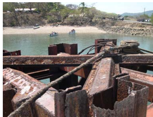
Figura Nº 22. "Sistema de amarre". Duque muy deteriorado
