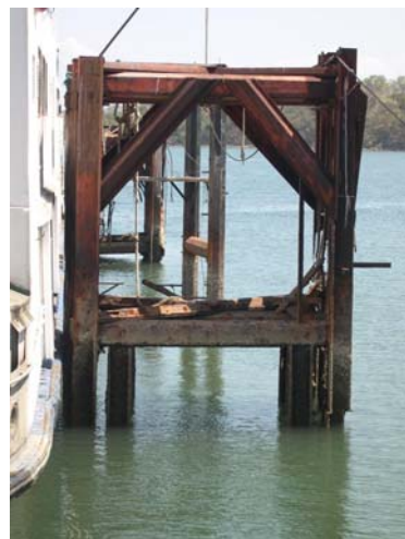
Figura N° 24. No existen defensas en ninguno de los duques
