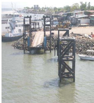
Figura N° 37. Duques en buen estado, no obstante hay una defensa suelta en el duque que está más al oeste en la rampa norte.
