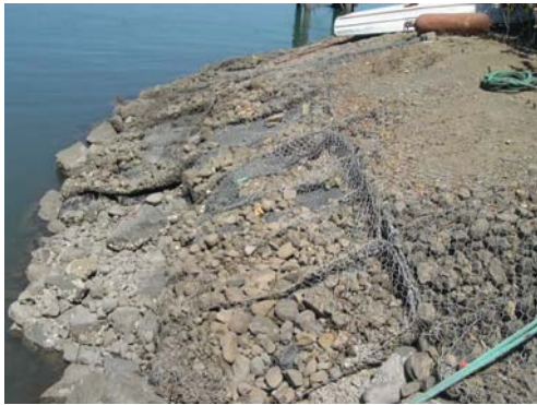
Figura Nº 15. Protección del sector Oeste, colchonetas en regular estado.
