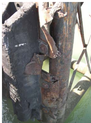
Figura N° 6. Defensa de neopreno y base en mal estado
