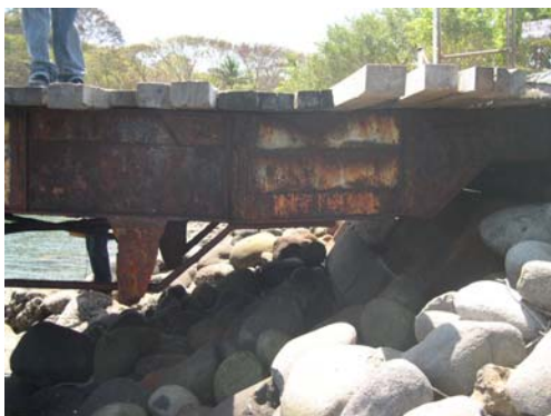
Figura N° 29. Deformación de las vigas principales por golpes sufridos
