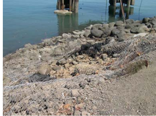
Figura Nº 16. Protección del sector Norte-Oeste, colchonetas deterioradas
