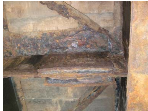
Figura Nº 28. Elementos principales completamente deteriorados
