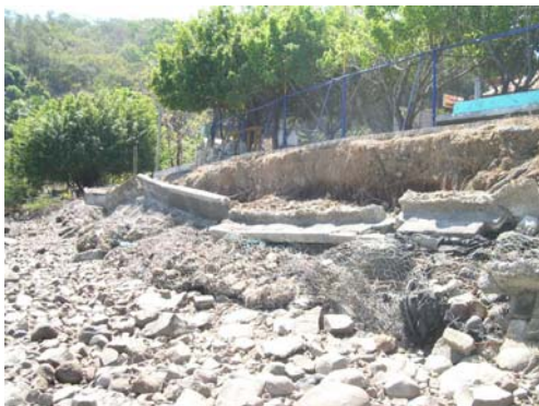
Figura N°13. Sector Este, muro completamente destruido.
