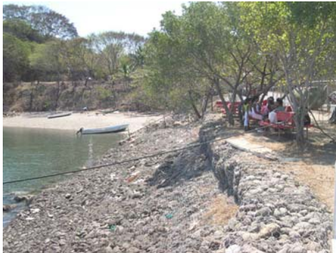
Figura Nº 32. Sector sin protección al oleaje.
