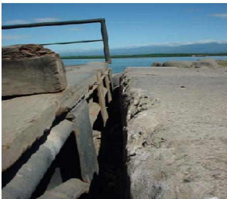
Figura Nº 40. Deformación del parapeto del bloque de apoyo.
