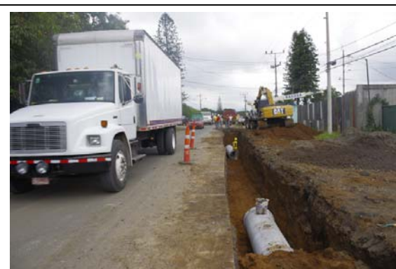
En algunos lugares donde los postes están fuera del derecho de vía se ha trabajado en el entubado
