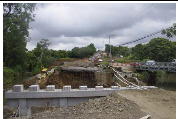
El puente sobre el río Segundo ya muestra un avance significativo a nivel de bases
