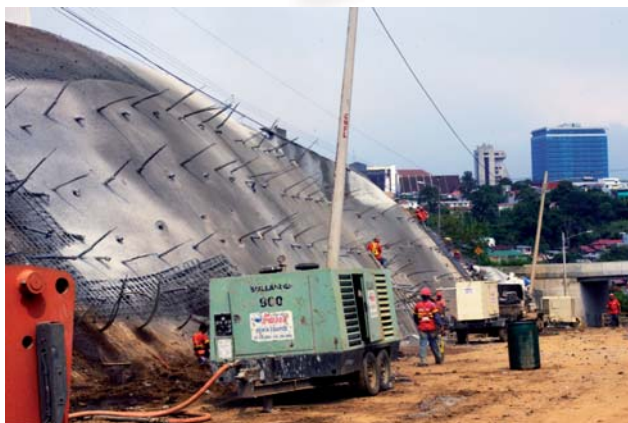
Pernos, malla electrosoldada y concreto inyectado fueron parte de las soluciones a los taludes en la radial
