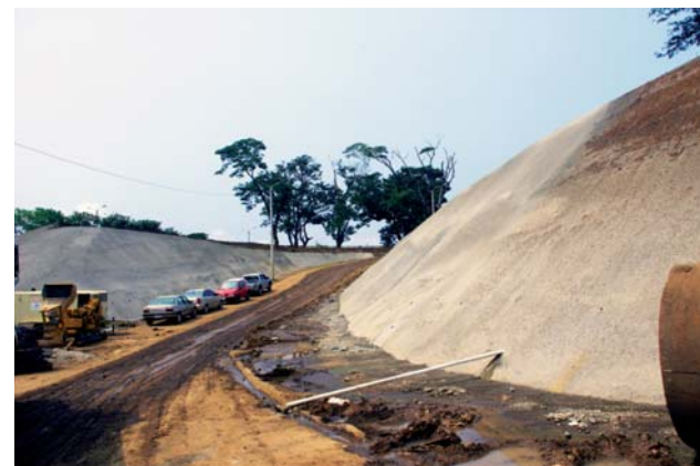
A la fecha se han invertido $2.7 millones para solucionar el problema de la inestabilidad de taludes
