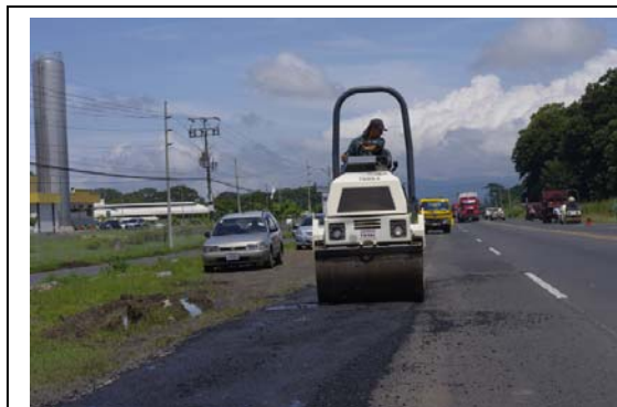
Se colocarán 200 toneladas métricas de asfalto entre el Aeropuerto y el cruce de Manolos
